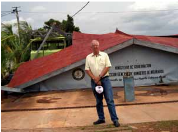
Se derrumba estación de bomberos —El techo de una de las estaciones de bomberos de Puerto Cabezas, colapsó y cayó sobre las ambulancias, disminuyendo el número de vehículos disponibles para rescate y emergencias. El experto en actividades de ayuda en Verbo Nicaragua, Bob Trolese, planea ayudar a la reconstrucción de este lugar por un largo plazo.
